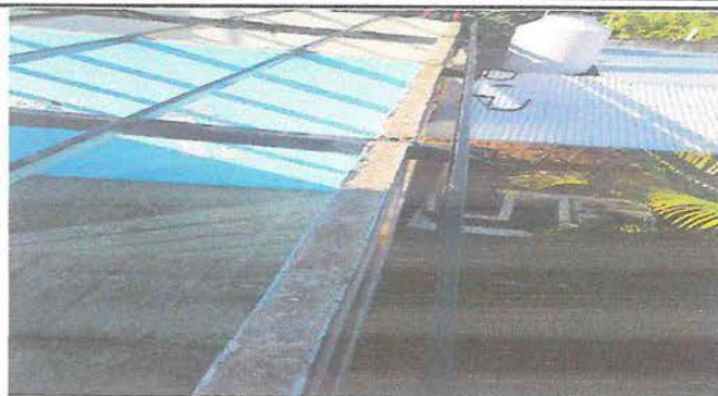
Foto 1. Aulas sin lamina
